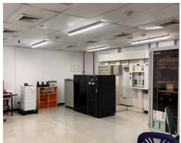
ห้องงานระบบไอที
