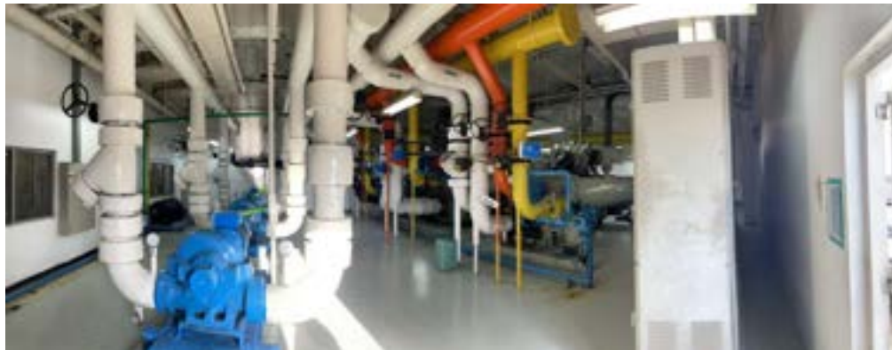
สภาพงานระบบภายในอาคาร-ห้องแอร์чилเลอร์ (Chiller Room)
