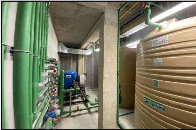
สภาพภายในอาคารชั้นล่าง / บริเวณห้องระบบประปา
