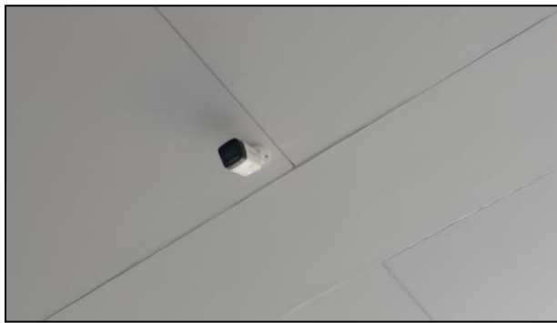
งานระบบ CCTV
