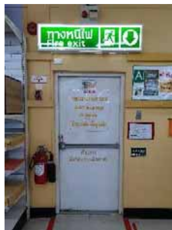
สภาพงานระบบป้องกันอัคคีภัย
