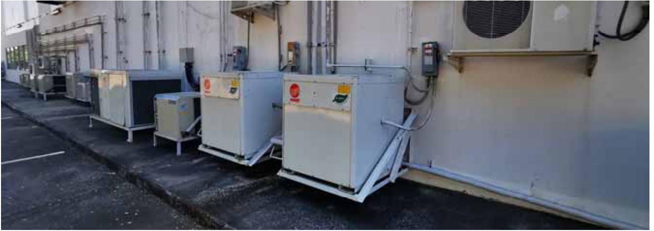
สภาพงานระบบปรับอากาศ
