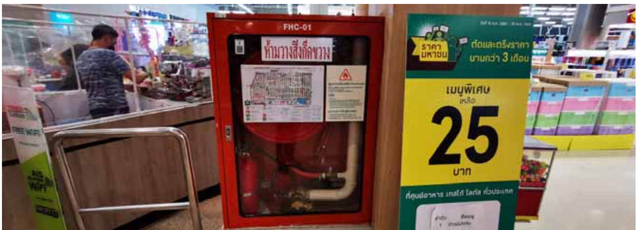
สภาพงานระบบป้องกันอัคคีภัย
