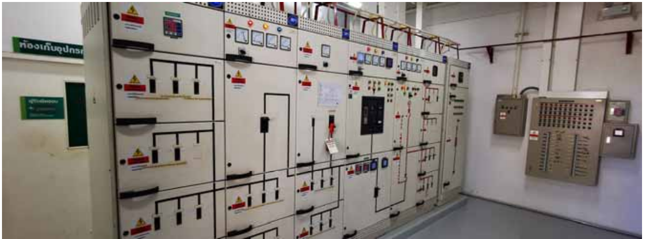
สภาพงานระบบไฟฟ้า
