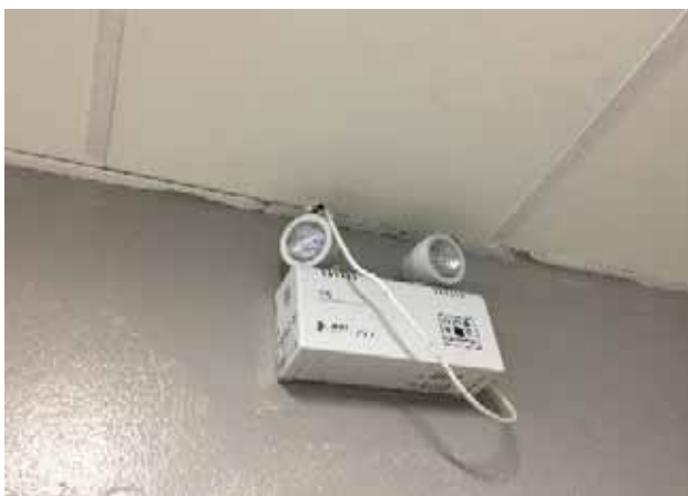
ระบบไฟฉุกเฉิน
