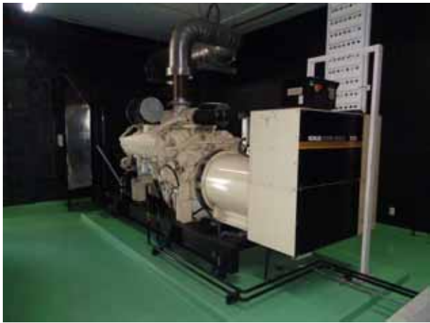
สภาพงานระบบไฟฟ้าสำรอง
