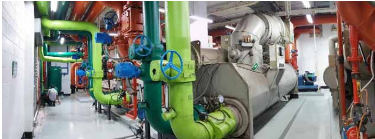
งานระบบปรับอากาศ (Air Cooled Chiller)
