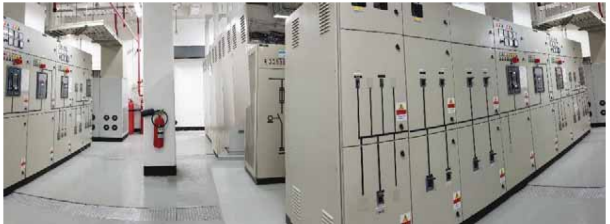
งานระบบไฟฟ้า (MDB)
