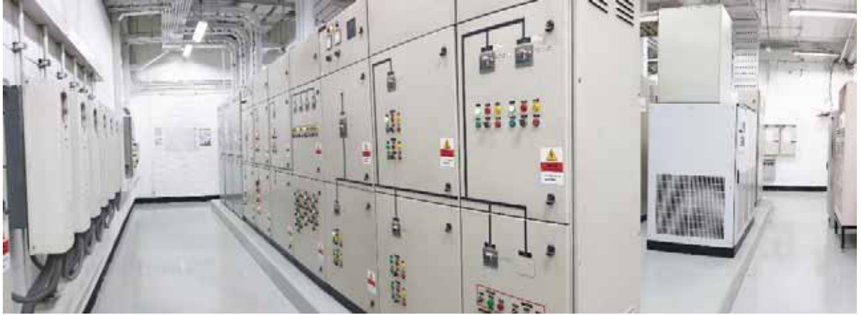
งานระบบไฟฟ้า (MDB)
