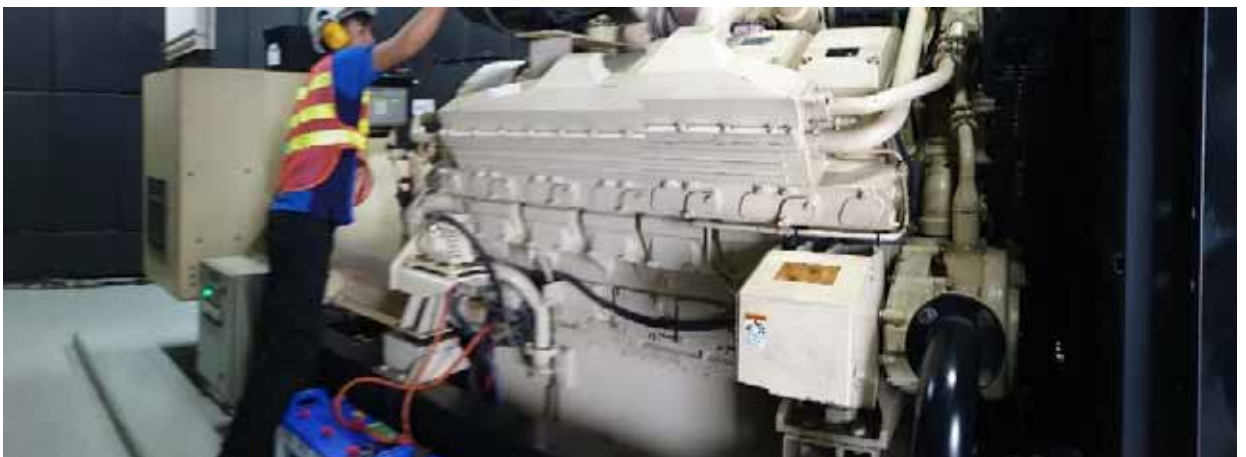
งานระบบไฟฟ้าสำรอง (Generator)
