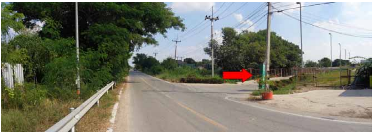
สภาพถนนคันกั้นน้ำสายเสนา - บางไทร บริเวณผ่านด้านหลังทรัพย์สินที่ประเมินมูลค่า (จุดถ่ายภาพที่ 3)
