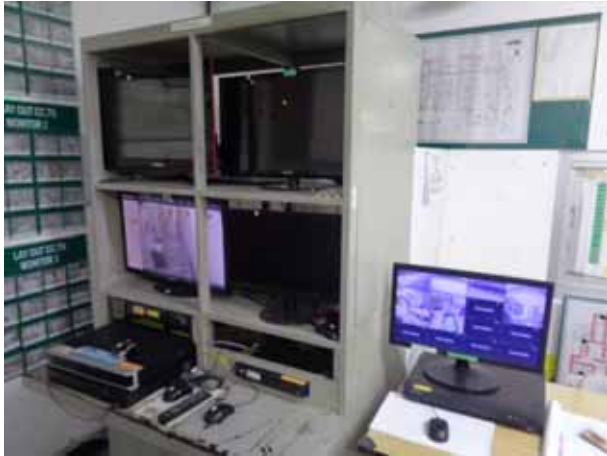
สภาพงานระบบวงจรถัด
