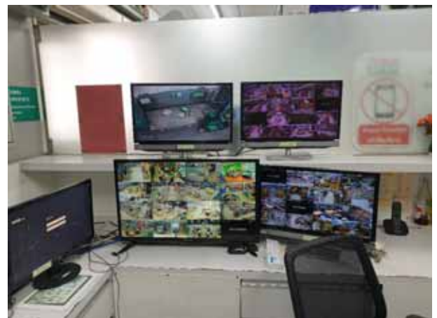
สภาพบริเวณพื้นที่ส่วนสำนักงาน (Back Office)
